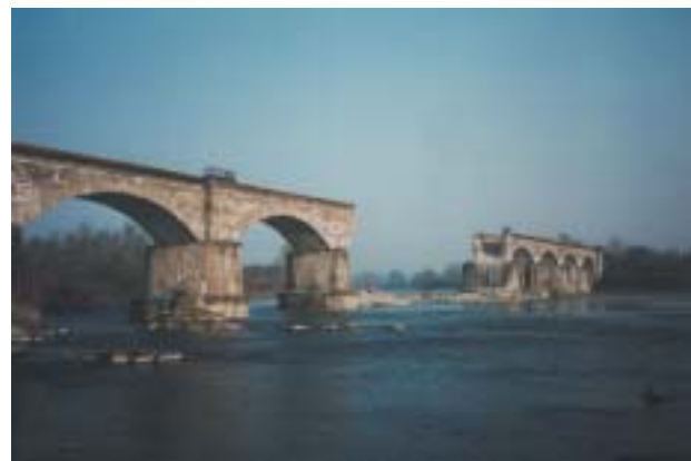
Il ponte sul Po, distrutto dall'alluvione del novembre 1994
